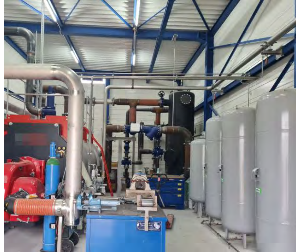
Kesselhaus einer Brauerei mit Freumdruckhaltung
