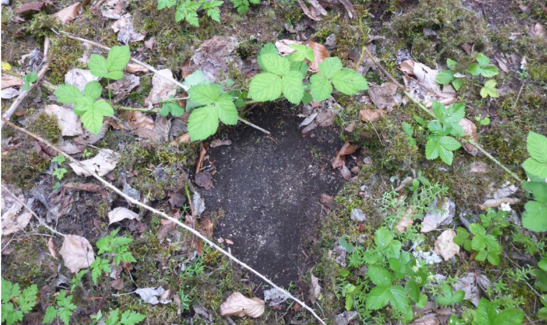
Abb. 2: Betonboden unter flachgründigem Substrat
