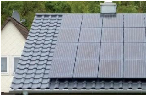
Abb. 12: PV-Anlage als Teilfläche in Aufdachmontage mit Bezug zum Dachdeckungsmaterial – Einfamilienhaus in Hagenohsen (Foto: Roland Krippner).
