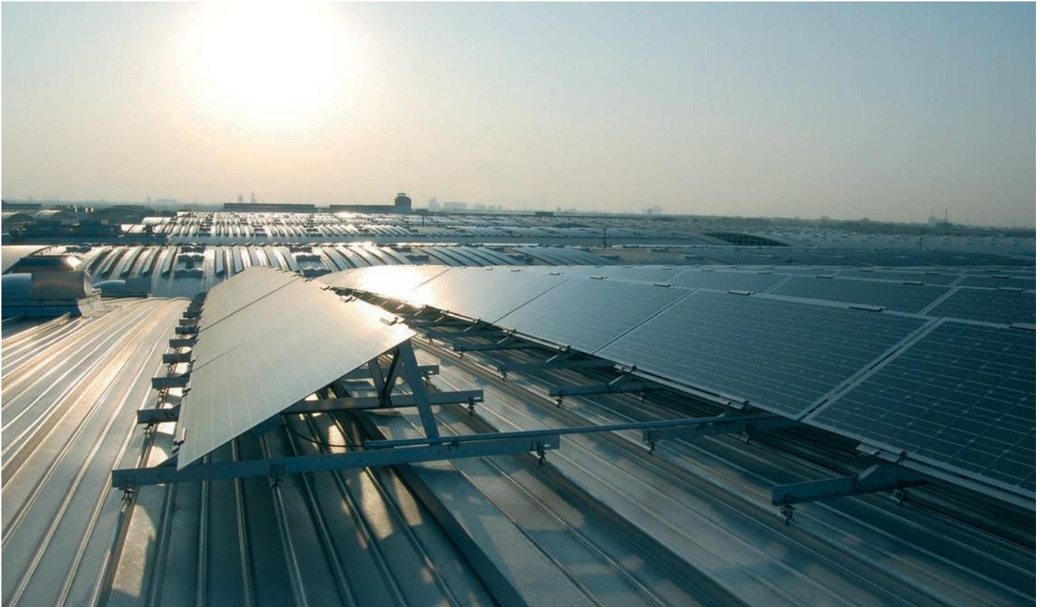
Abb. 7: Das Montagesystem ist am Stehfalz des Metaldaches befestigt – Solardach Messe München (Foto: Fabian Flade).
