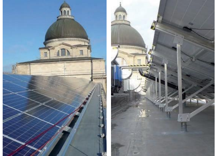
Abb. 6: Aufgeständerte PV-Anlage zwischen klimatechnischem Dachaufbau und Flachdach – Bayerische Staatskanzlei in München (Fotos: Urbane Energie).
