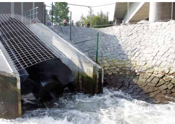
Kleinwasserkraftwerk an der Sempt
