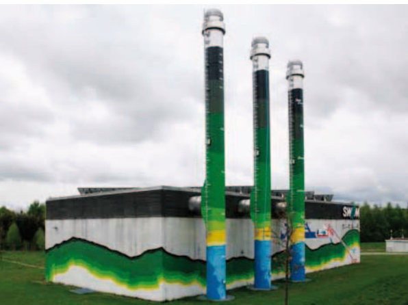
Mit dem Geothermieprojekt Riem waren die SWM bundesweit Vorreiter.
