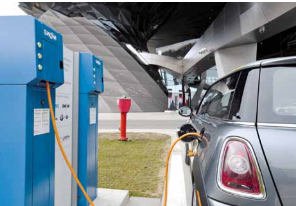
Ladesäule für Elektrofahrzeuge
