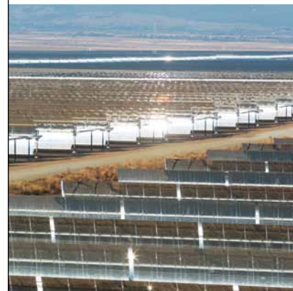
Das Solarkraftwerk Andasol 3 wird die Regelproduktion aufnehmen.
