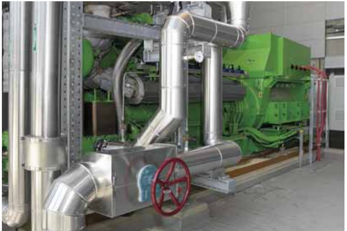
Neuer Gas-Otto-Motor (BHKW) in der Energiezentrale des Klärwerks Gut Marienhof
